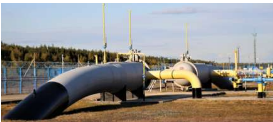
Рис. Узел пуска и приема станции очистки (диагностики) (УППСОД)
